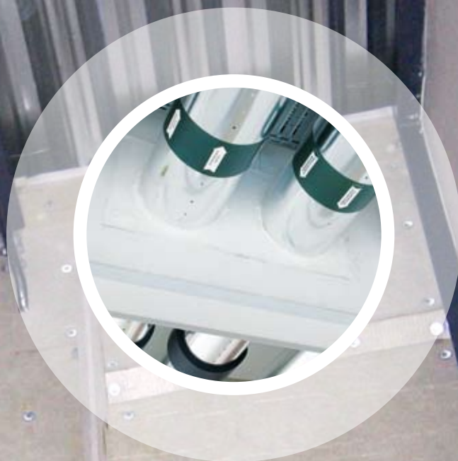
Brandlukning af installationsgennemføringer med brandplade.
